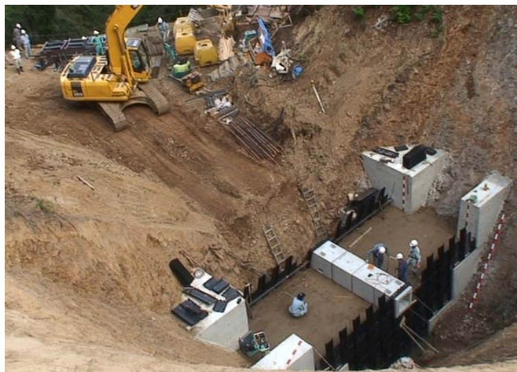
写真- 4.3 土砂ストック，混合ヤードの配置例：モデル2事例 (バックホウ混合→内部材製造，バックホウによる直接投入)
