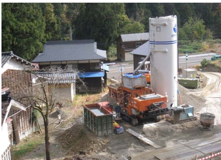
写真-4.5 土砂ストック，混合ヤードの配置例：モデル3事例 (INSEM プラント→内部材製造，ダンプトラック運搬)
