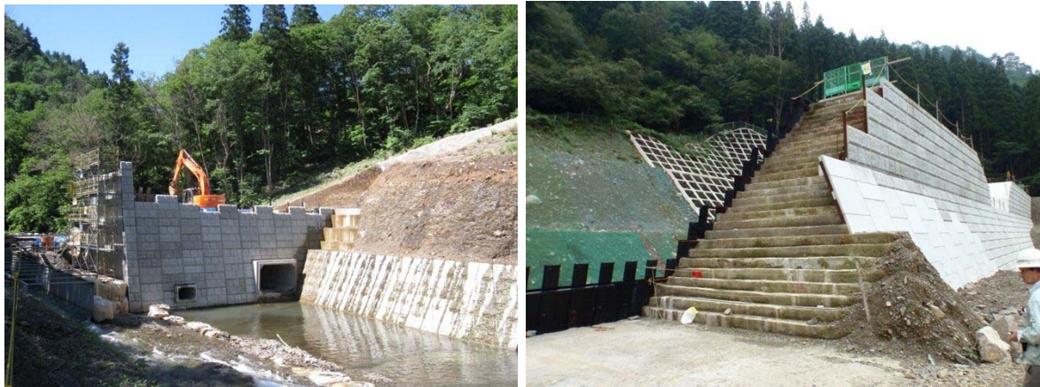
写真- 4.23 半川施工事例（左：隔壁設置例・右：スロープ状施工事例）
